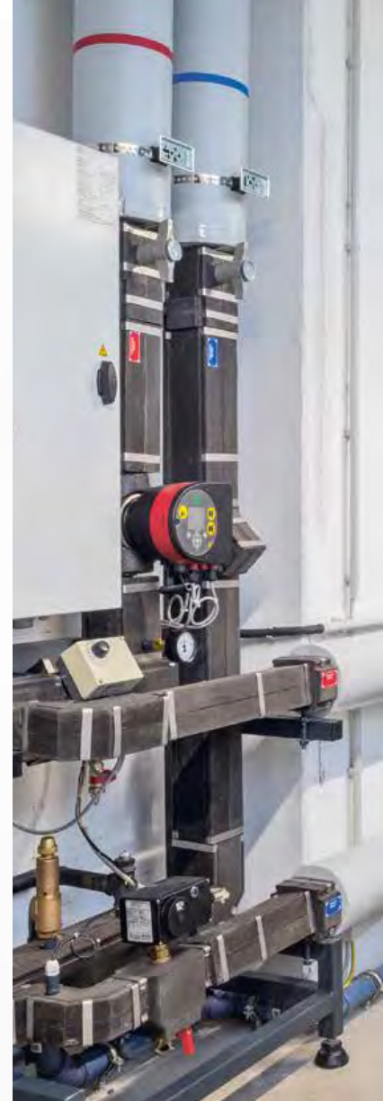
▲ Die Fernwärmeübergabestation versorgt die Wohnungsstationen mit Wärme zur Warmwassererzeugung.
